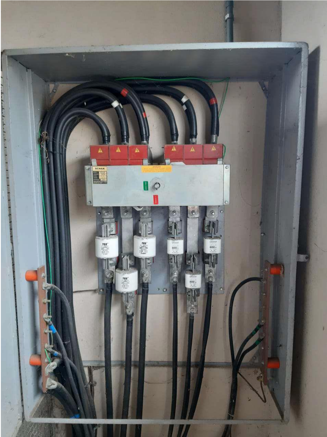
Figura 8: QGBT Quadro geral de baixa tensão Primário
