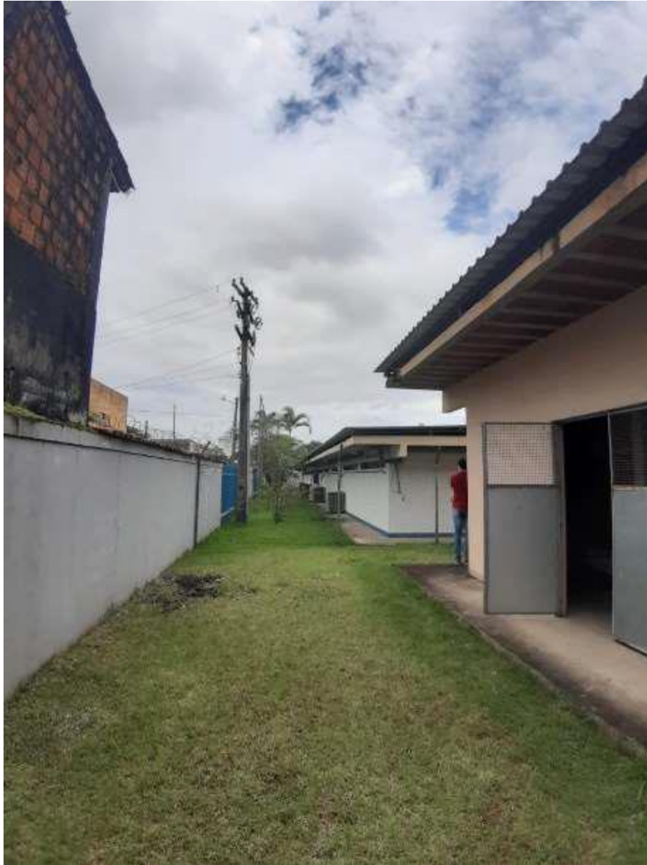
Figura 2: Poste concreto 11 Mt, com estrutura AT – Cruzetas de madeira, chaves fusíveis e para raio.
