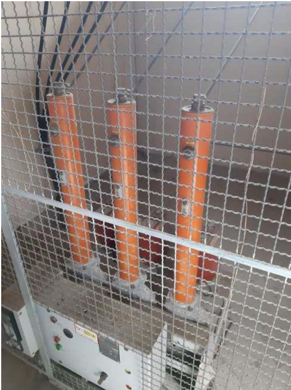
Figura 4: Disjuntor Beghim – PVO, tensão nominal 17.5 KV, corrente nominal 630 Amperes com relés de sobrecorrentes Pextrom 7104 que está desativado.
