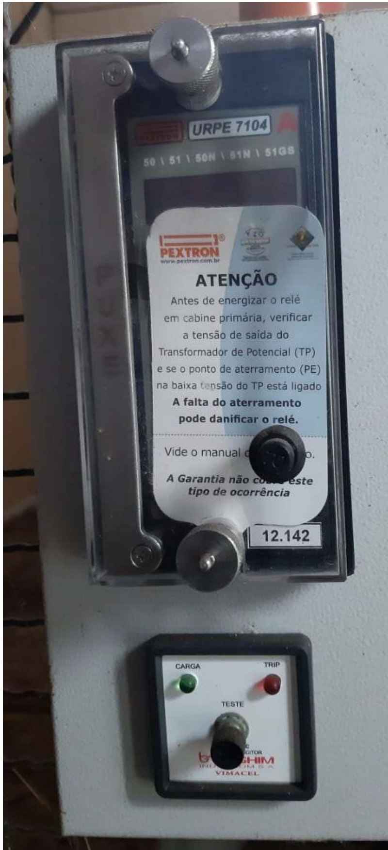
Figura 5: Relés de sobrecorrentes Pextron 7104, encontrasse desligado.
