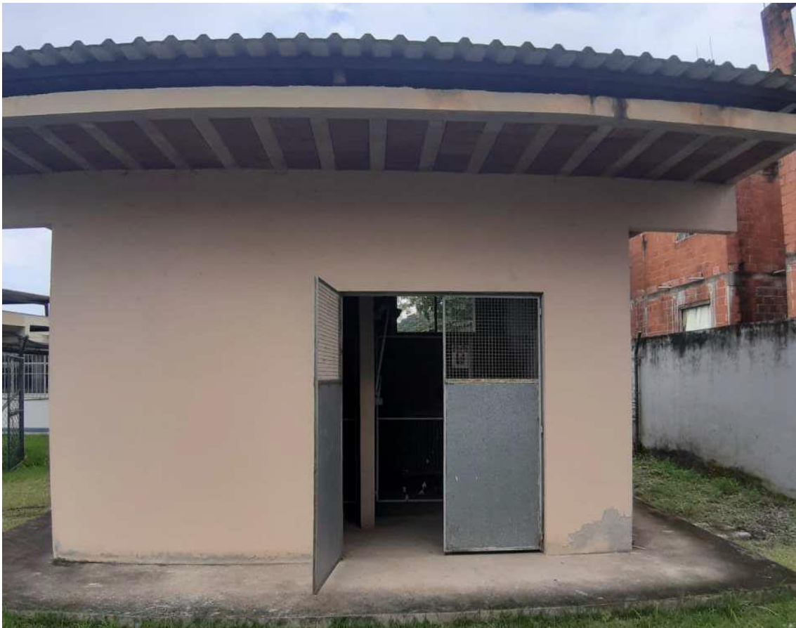
Figura 1: Subestação abrigada, tensão de entrada 11.4 KV, atendimento aéreo pela Cia distribuidora Enel, migrando no poste do cliente para ligação subterrâneo através de Mufla interligada a chave seccionadora tripolar - abertura sem carga e sem base fusível (modelo SFT).
