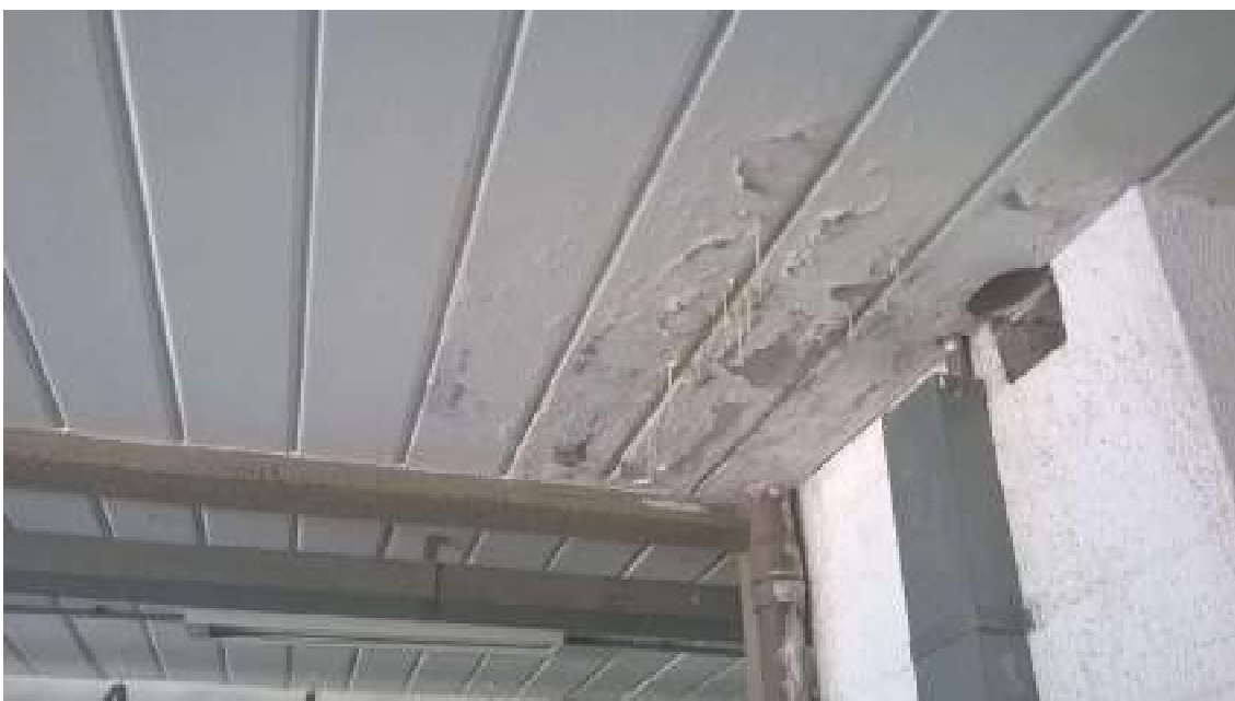
FOTO 05 – MARCAS DE INFILTRAÇÃO NO TETO – CAMPUS ITAGUAÍ
