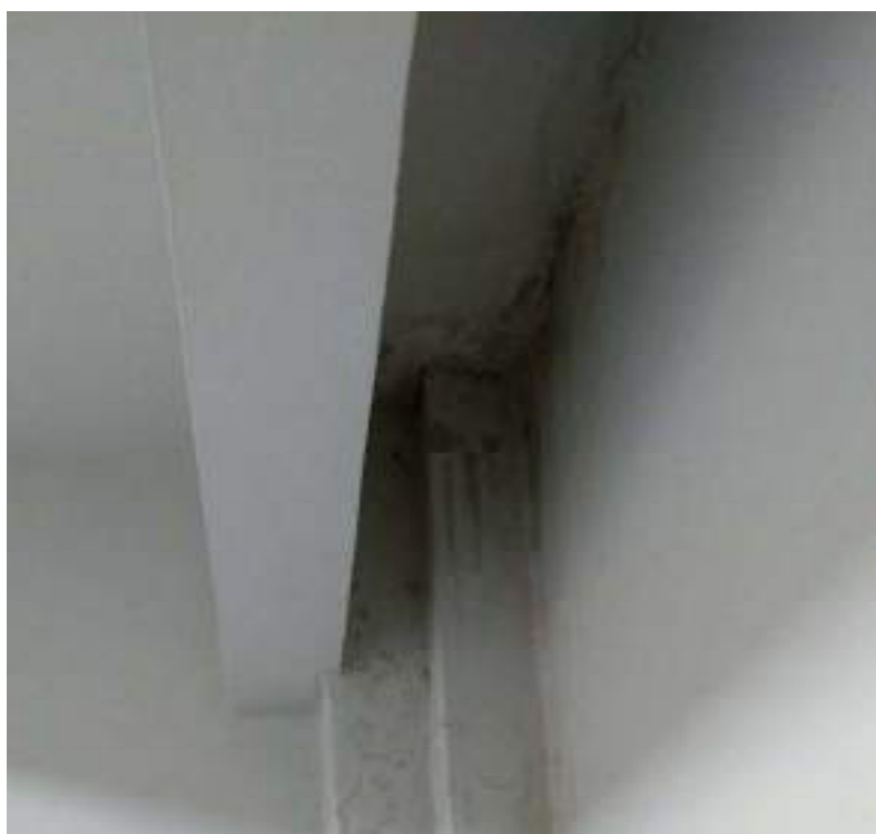
FOTO 06 – MARCAS DE INFILTRAÇÕES NO TETO – CAMPUS MARACANÃ
