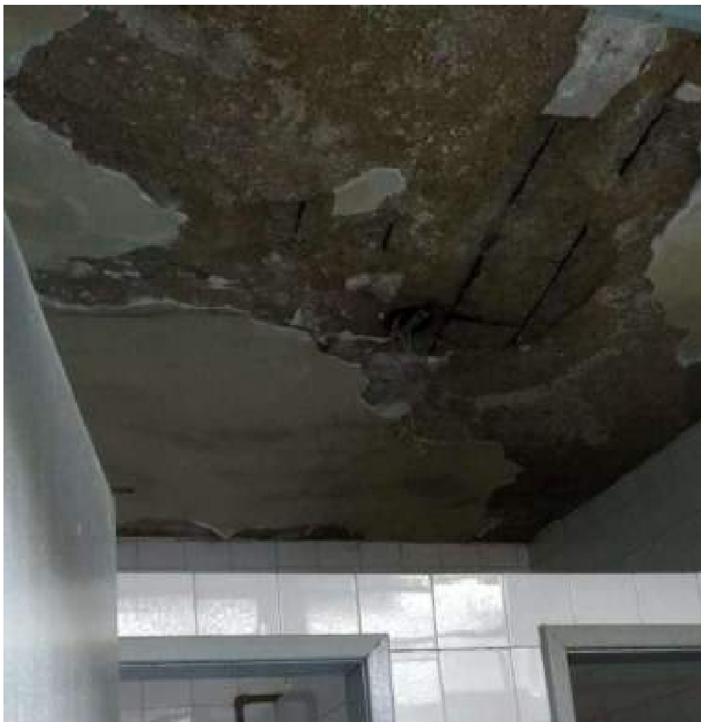
FOTO 07 – MARCAS DE INFILTRAÇÕES NO TETO DOS BANHEIROS – CAMPUS MARACANÃ
