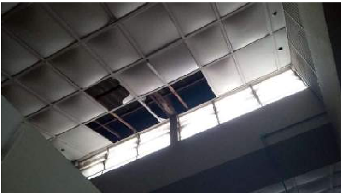
FOTO 04 – FORRO DO TETO DANIFICADO – CAMPUS MARIA DA GRAÇA
