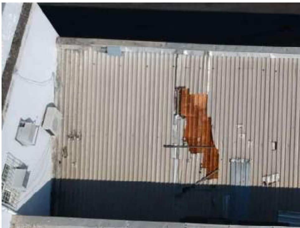
FOTO 08 – TELHADO DANIFICADO DOS PAVILHÕES – CAMPUS MARACANÃ
