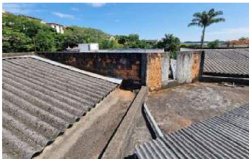
FOTO 03 – COBERTURA ANTIGA E REVESTIMENTOS DANIFICADOS – CAMPUS VALENÇA
