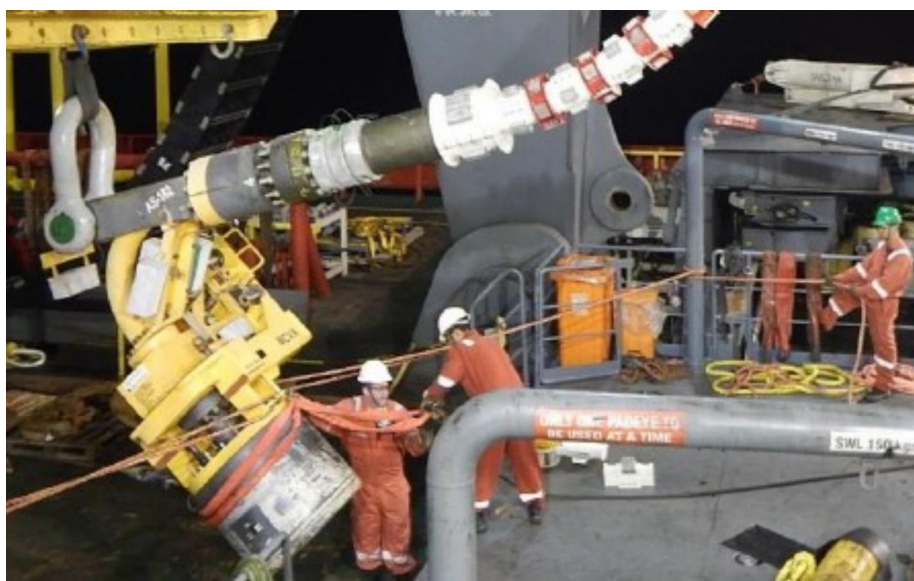
Figura 6 – MCV conectado ao duto Flexível antes da instalação. (Fonte: Silva, 2021).
