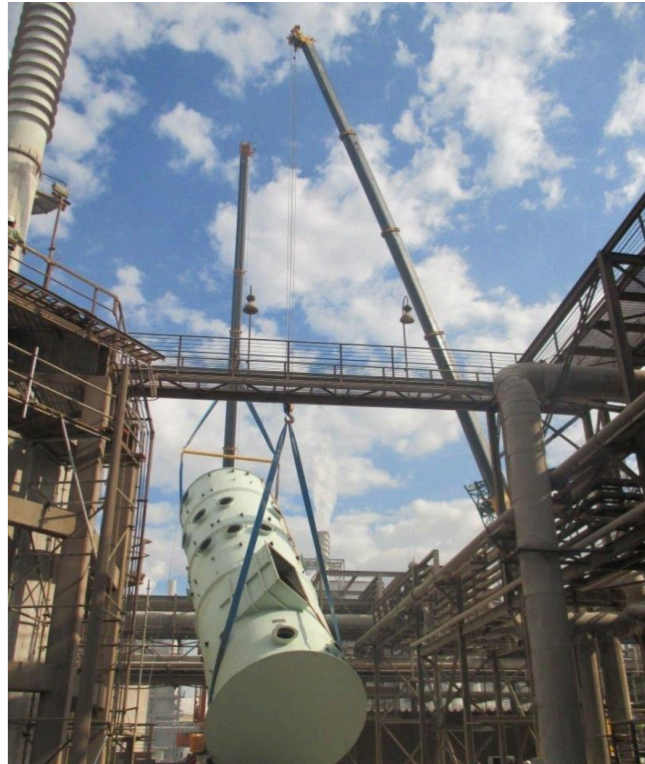
Figura 6 - Verticalização de um lavador de gases feito de fibra de vidro. Fonte: < www.montcalm.com.br > Acesso em 14/02/2016
