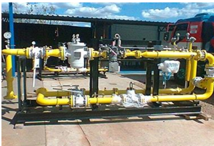
Figura 3.39 - Skid de estação de regulação e medição
